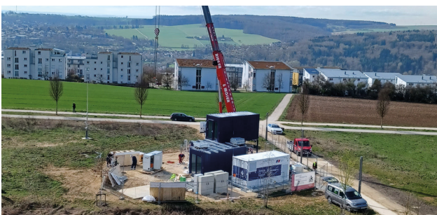
Abbildung 22 | Aufbau Gasturbine im Energiepark am Standort AEA
